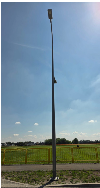
Przy drodze powiatowej zamontowano nowoczesne lampy
